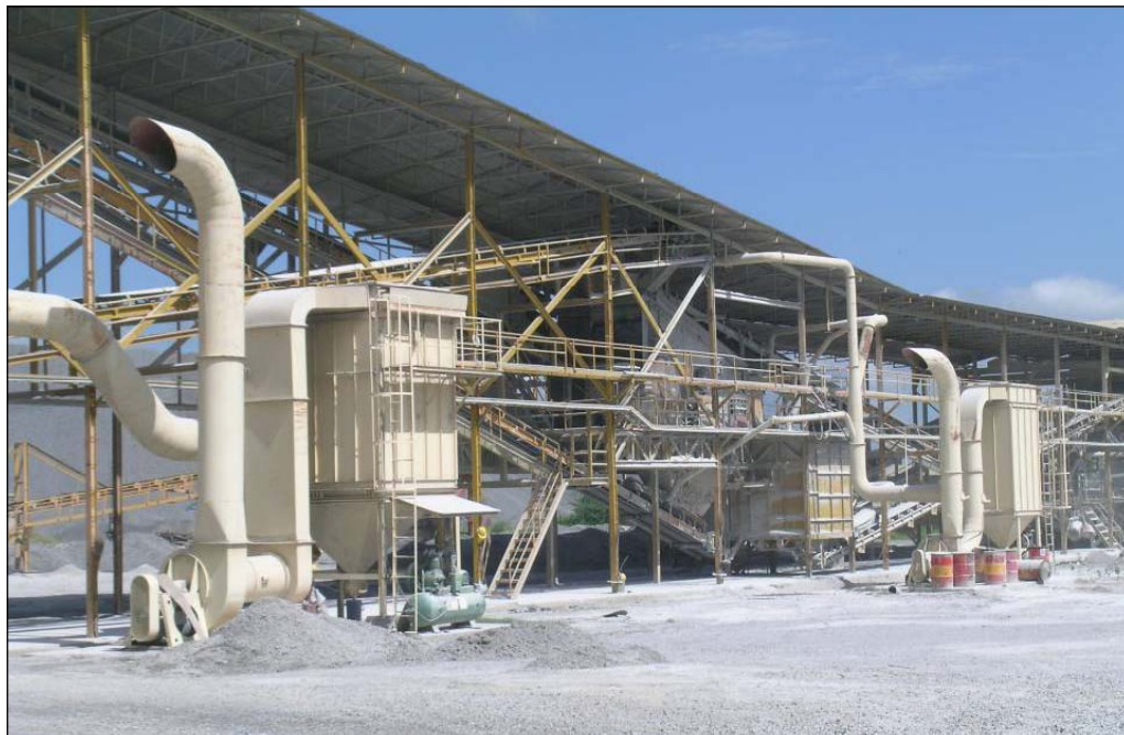
ระบบควบคุมฝุ่นโรงโม่หิน- ระบบถุงกรอง Bag Filter
